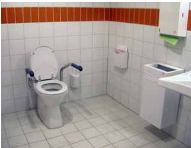
Det er viktig at utstyr på handikoptoalettene er riktig utformet og plassert. Dette toalettet har imidlertid dårlige kontraster for synshemmede, da både gulv, vegger og utstyr er hvitt. Foto: Ingfrid Bækken, Bergen Byarkiv.
